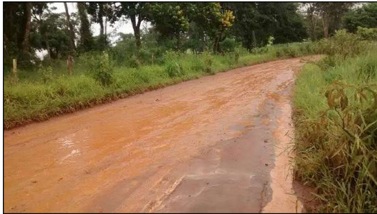
Figura 13 - Ponto crítico de pista escorregadia.
