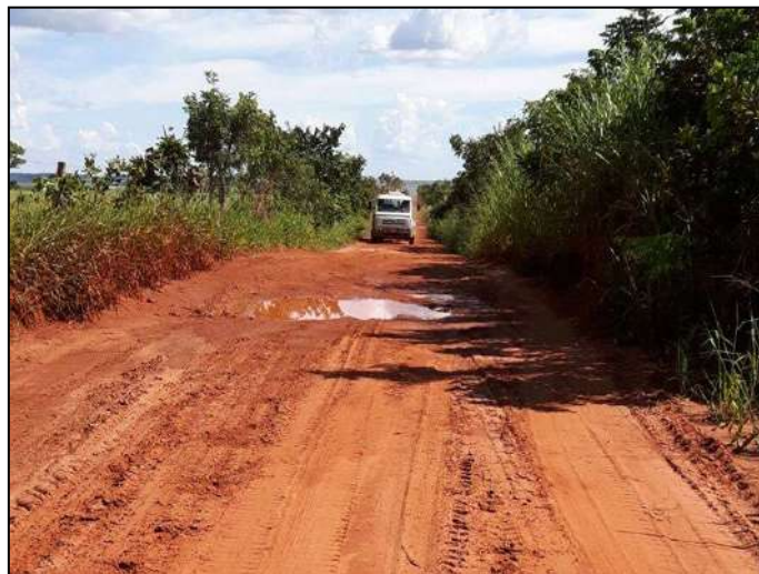
Figura 14 - Ponto crítico de empoçamento.
