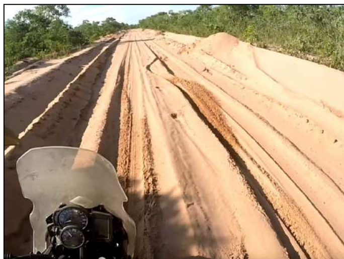
Figura 7 - Ponto crítico de areião severo.
