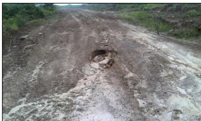
Figura 19 - Ponto crítico de erosão no leito carroçável da estrada.
