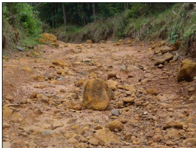
Figura 5 - Ponto crítico severo de afloramento de rocha.
