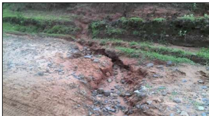
Figura 18 - Ponto crítico de erosão nas sarjetas da estrada.
